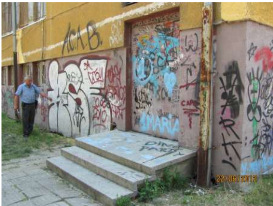
Фиг.3: Бл.2 –Напукване в ъгловата зона и в близост до трафопоста
