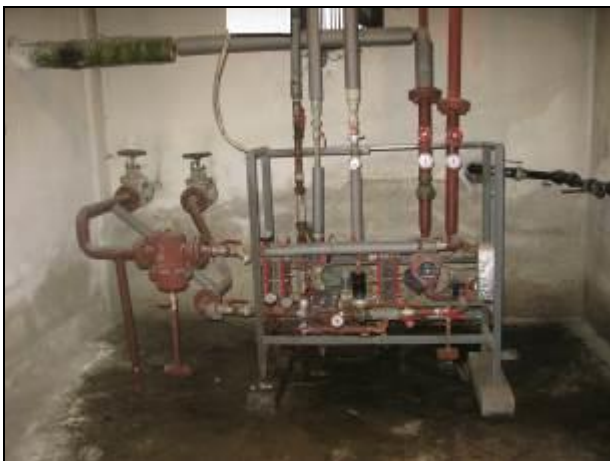
Фиг.1.18 Абонатна станция блок №3
